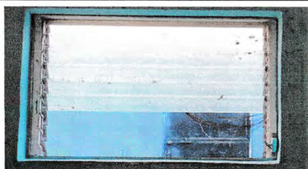
Foto 3: ventana en mal estado 0.82 mts. De largo X 0.80 mts
