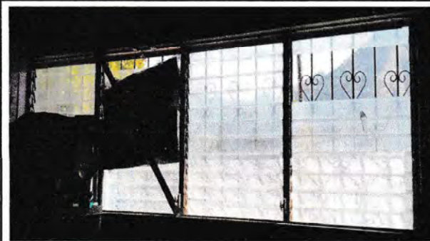
Foto 4: ventana en mal estado 3.52 mts. De largo X 1.02 mts. De Alto.
