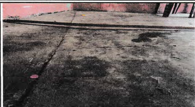
Foto1: Hundimiento del piso de torta.
