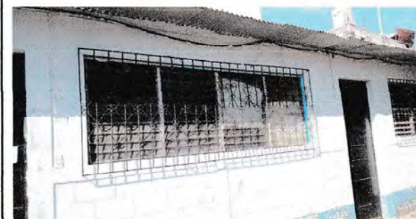
Foto 6: se retiraron los canales eran un peligro para los niños debido a su deterioro
