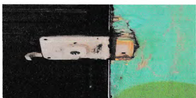
Foto 5: chapa de puerta de metal en mal estado. es difícil abrir la puerta.
